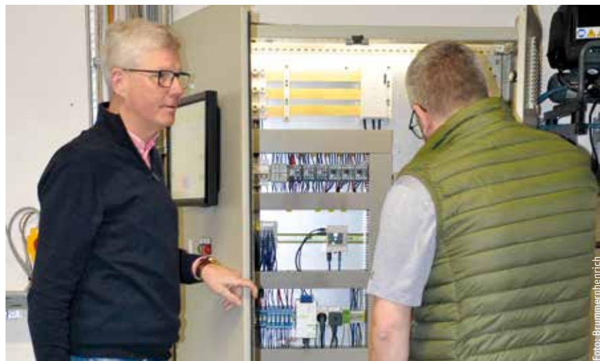
Projektleiter Markus Orbke (li) mit Firmenchef Klaus Brummernhenrich (re) vor dem umgebauten Schaltschrank
